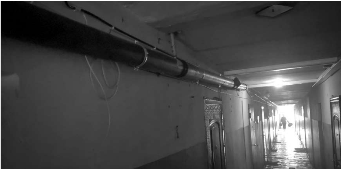
Kanalizacijos vamzdis bendrabutyje įrengtas virš kitų gyventojų butų durų.
